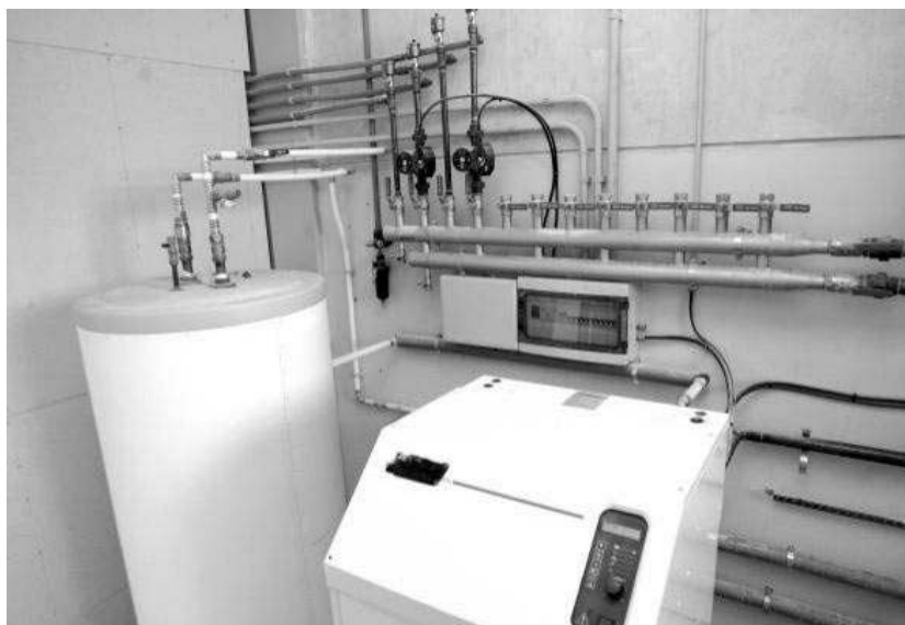
Geotermiako bero ponpa, Araiako kiroldegia
